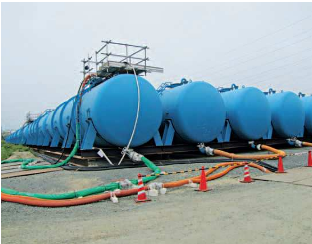
G) Tanks der Wasseraufbereitungsanlage (Quelle: TEPCO)
